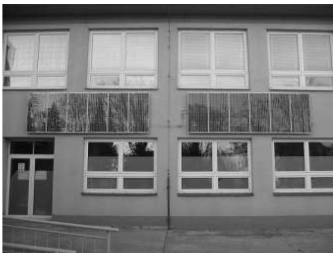
Obrázek 1: Solární panely na stěně budovy školy.
